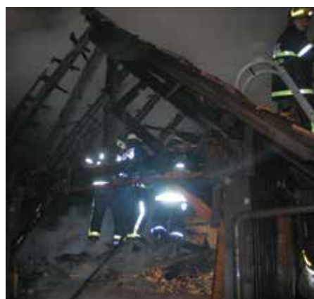
Sp. Slivnica 2007. Požar vrtna lope.
