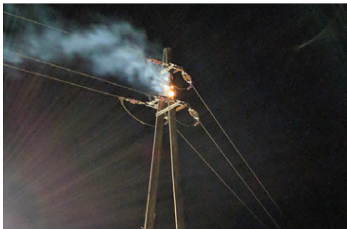
Požar električnega droga pri gasilskem domu, 22. 11. 2017.
