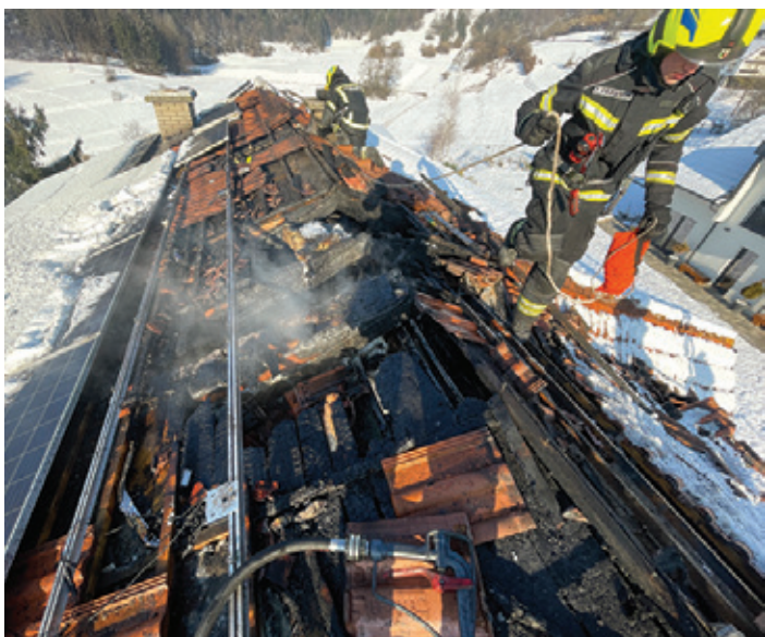
Požar ostrešja stanovanjske hiše v Dolenji vasi pri Polici, 19. 2. 2025.
