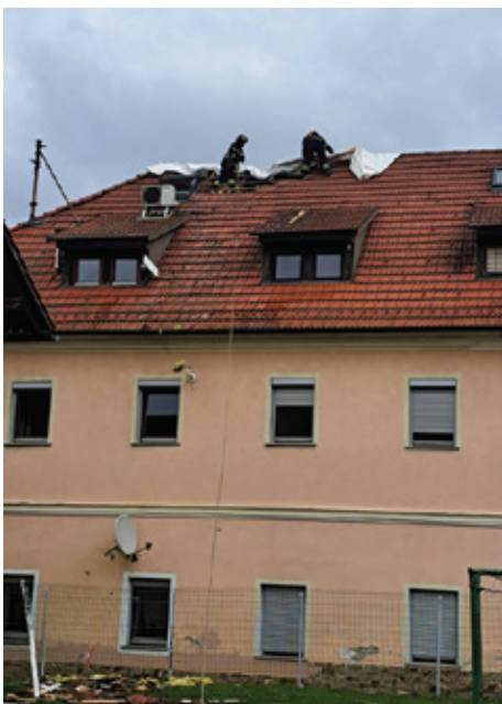
DESN0: Prekrivanje zgorelega ostrešja po pogašenem požaru.
