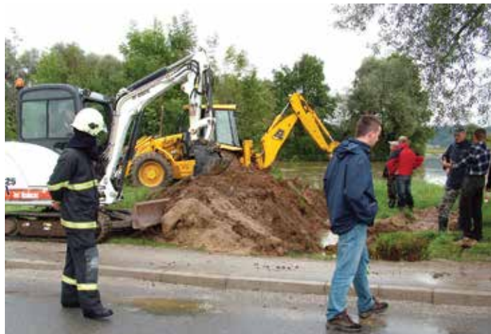
2010 – Poplave: Ob gradnji ceste in nasipanju okoliškega terena so zasuli star cestni propust, ki ga je bilo treba odkopati, da je voda odtekla.
